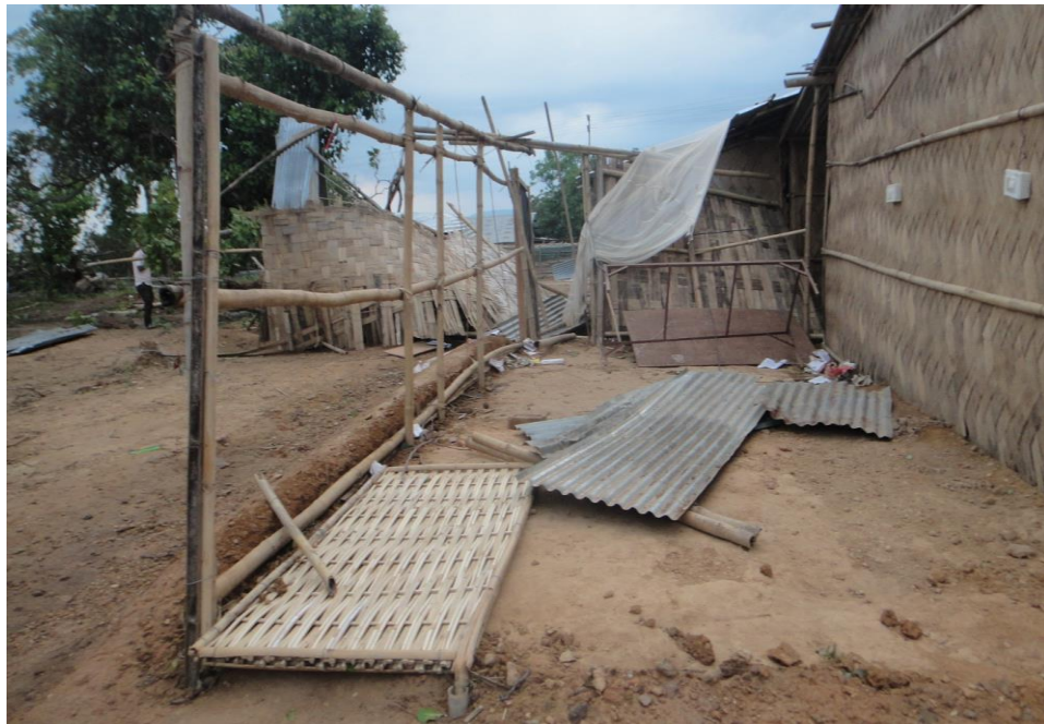
Zerstörung des Schulhauses beim Sturm über Ostern 2015
